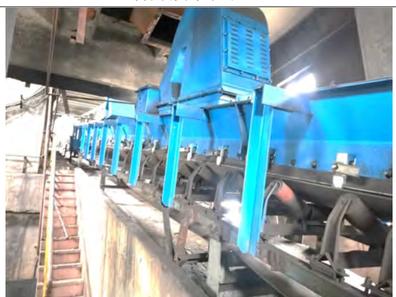
输煤廊内煤炭转运点双密封导料槽
