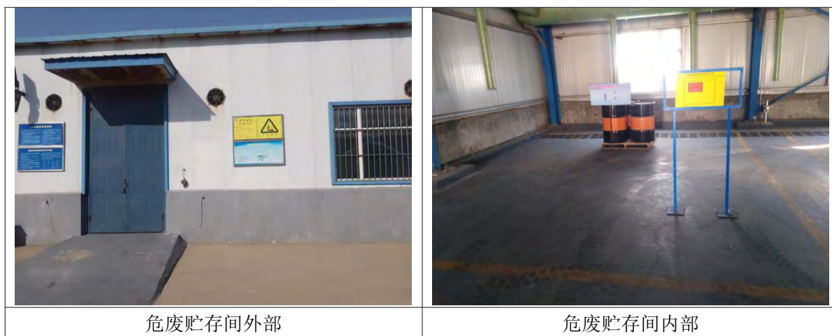
图 4.1-7 危险废物收集设施
