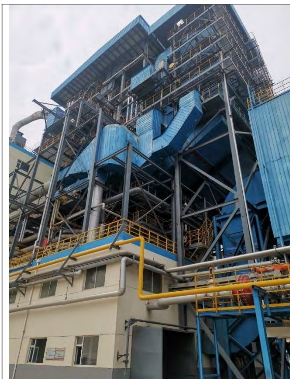
锅炉房及 SCR 脱硝
