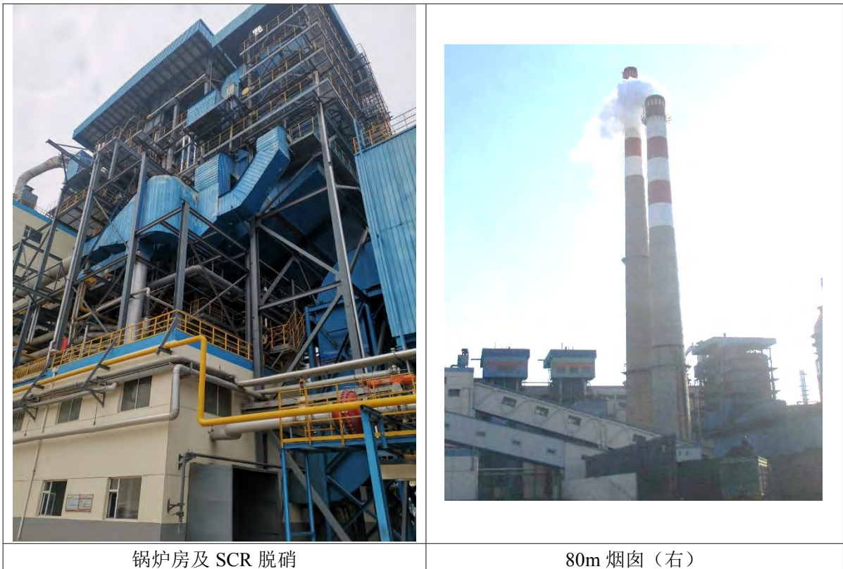
图 4.1-4 有组织废气治理设施
